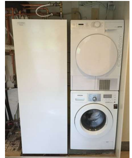
Varmepumpe indedel med 300 L buffertank. Lige så stor som en vaskesøjle.
